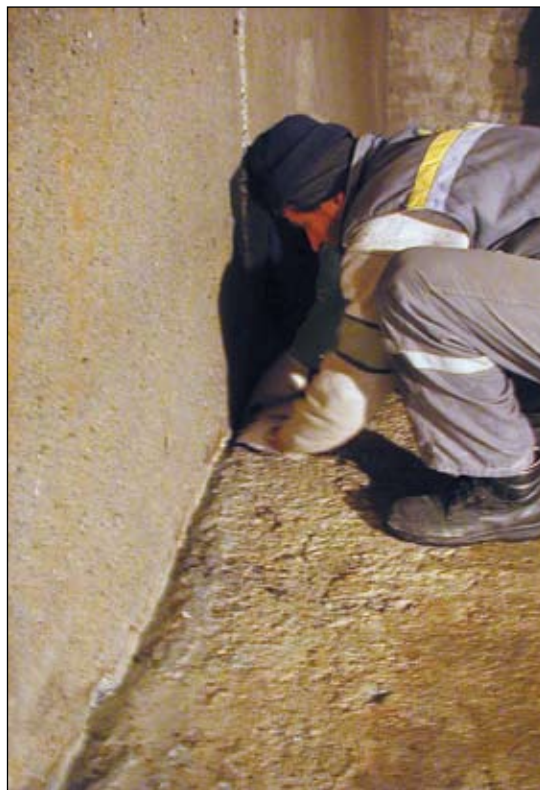
Spoj temeljne ploče i armiranobetonskog zida stalno je propuštao vodu. Tu je spojna crta najprije proširena i očišćena, a zatim je punom duljinom utora utisnut krystol-plug koji je zaustavio protok.
